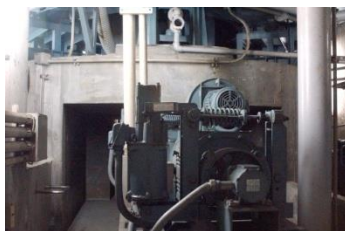
駆動モーター(地下室)
