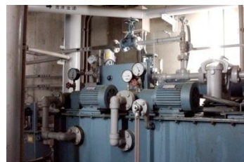
油圧装置(地下室)
