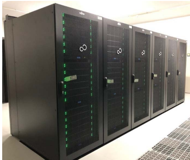
新スーパーコンピュータシステムの外観
