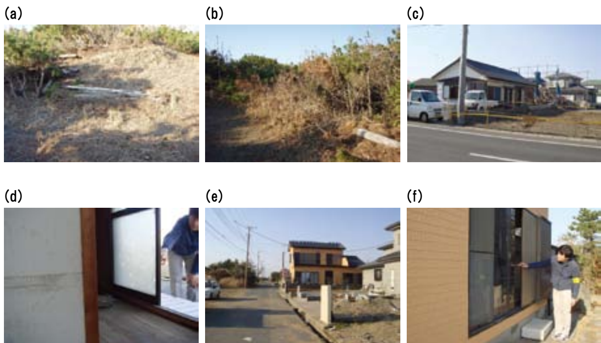
写真 A13. 旭市三川（地点番号 No. 102, 110, 111）の測定点とその周辺の様子. 地点番号 102 の測定点は(b)の紅白の標尺の根元, (a)は 102 の測定点と海岸の間の様子. 地点番号 110 の測定点は(c)に写っている家の右側で(d)の痕跡. 地点番号 111 の測定点は(e)中央に写っている家の手前側で(f)の痕跡.
