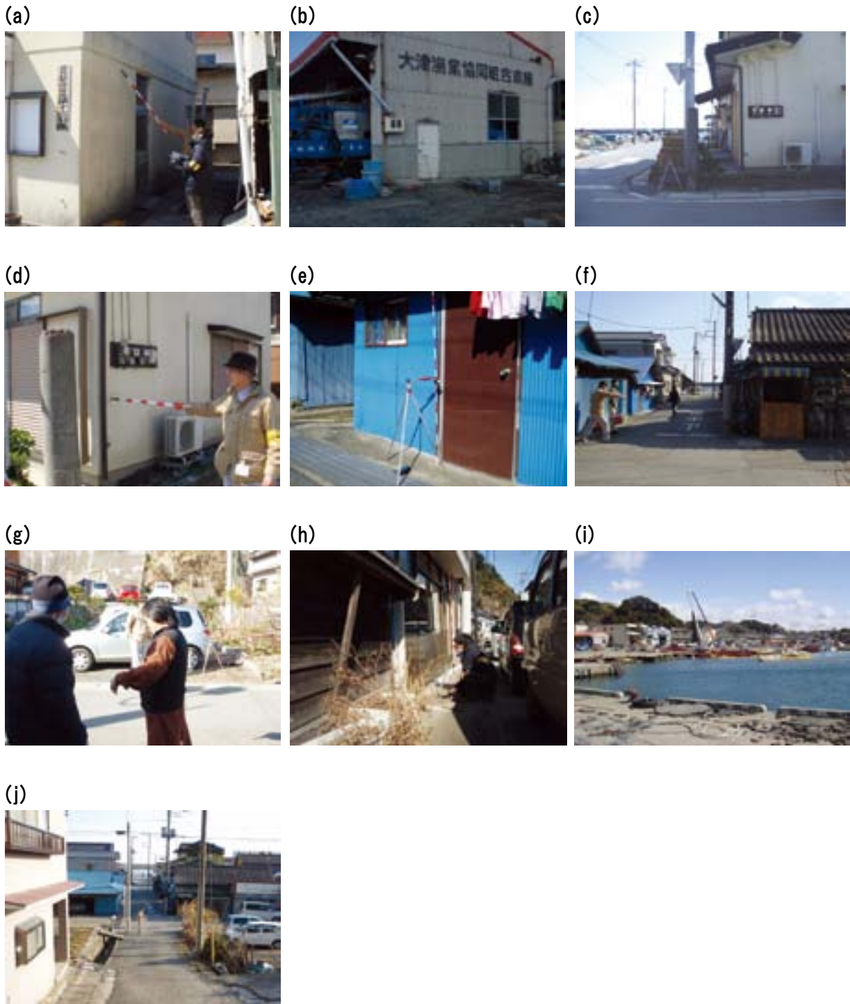
写真 A2. 北茨城市大津町(地点番号 12)の測定点とその周辺の様子. (a)～(h)は, 地点番号 12A(a), 12B(b), 12C(c, d), 12D(e), 12E(f), 12F(g), 12G(h)の測定点. (i)は大津漁港の埠頭の被害の様子. (j)は坂の上から測定点が並ぶ道を通って漁港を臨む.
