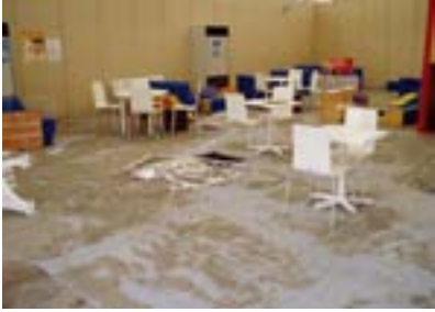
写真 A7. 大洗町港中央（地点番号 2）の測定点とその周辺の様子．(a)の写真の右側の側面に 2B の測定点(b)，左側の側面に 2A の測定点(c)がある．(d)は，(a)の店舗内の被害の様子．
